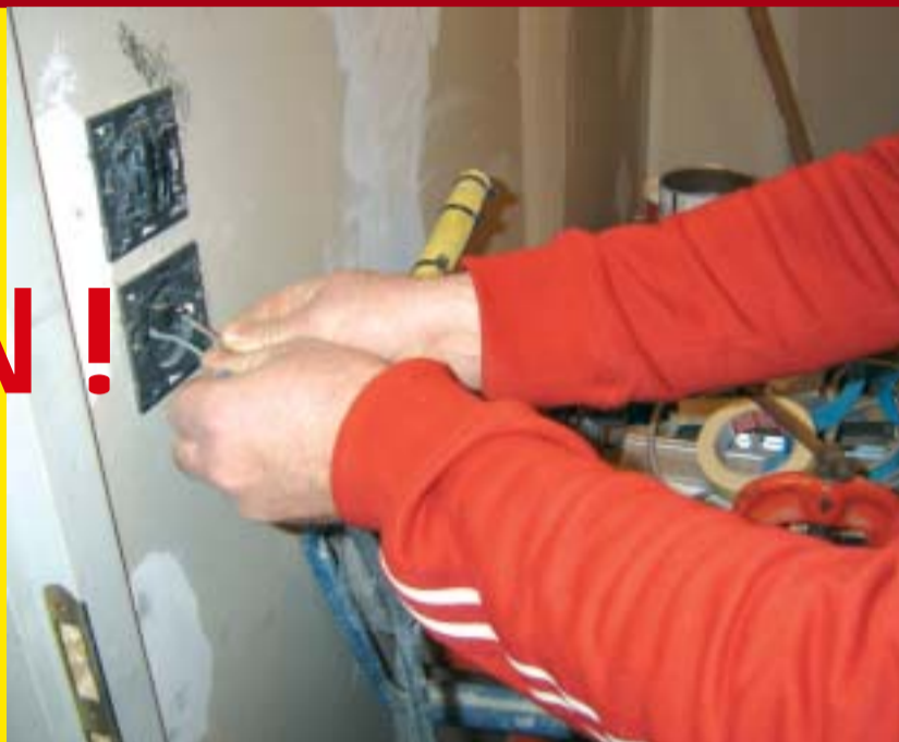
Installations improvisées ou bricolées peuvent avoir de lourdes conséquences...
